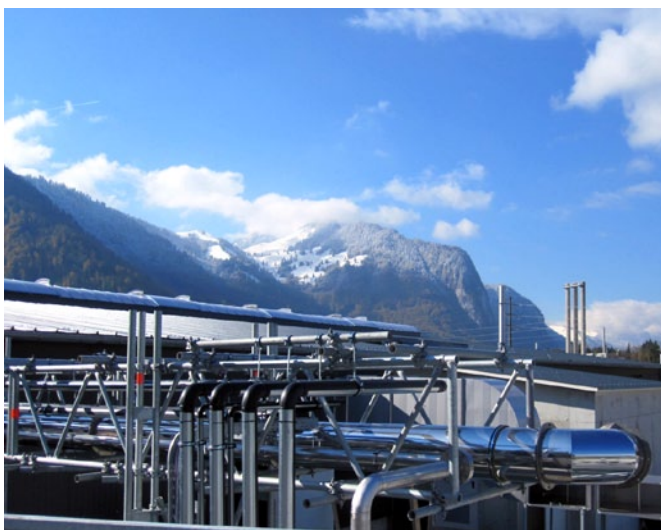
Dachaufbau Fermentation der Biogasanlage mit Blockheizkraftwerk in Spiez.
