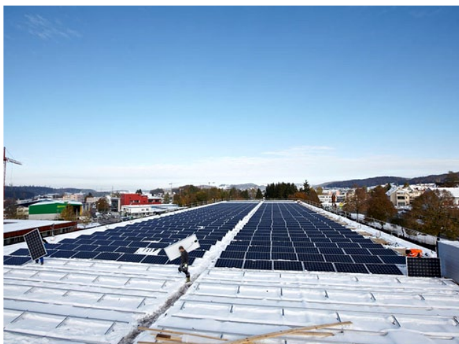
Installation der Photovoltaikanlage auf dem Sammlungszentrum Affoltern des Schweizerischen Nationalmuseums. Die Leistungsdaten sind im Internet abrufbar unter http://gemperle.solarlog-web.ch/11861.html .
