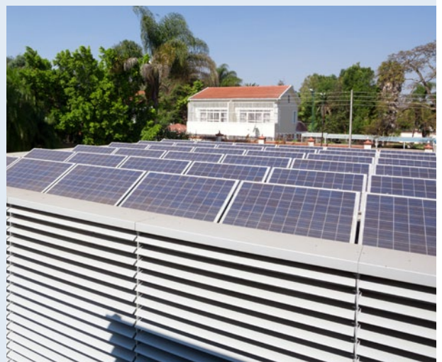
Photovoltaikanlage auf dem Dach des Kanzleigebäudes in der Botschaft in Harare, Zimbabwe.
