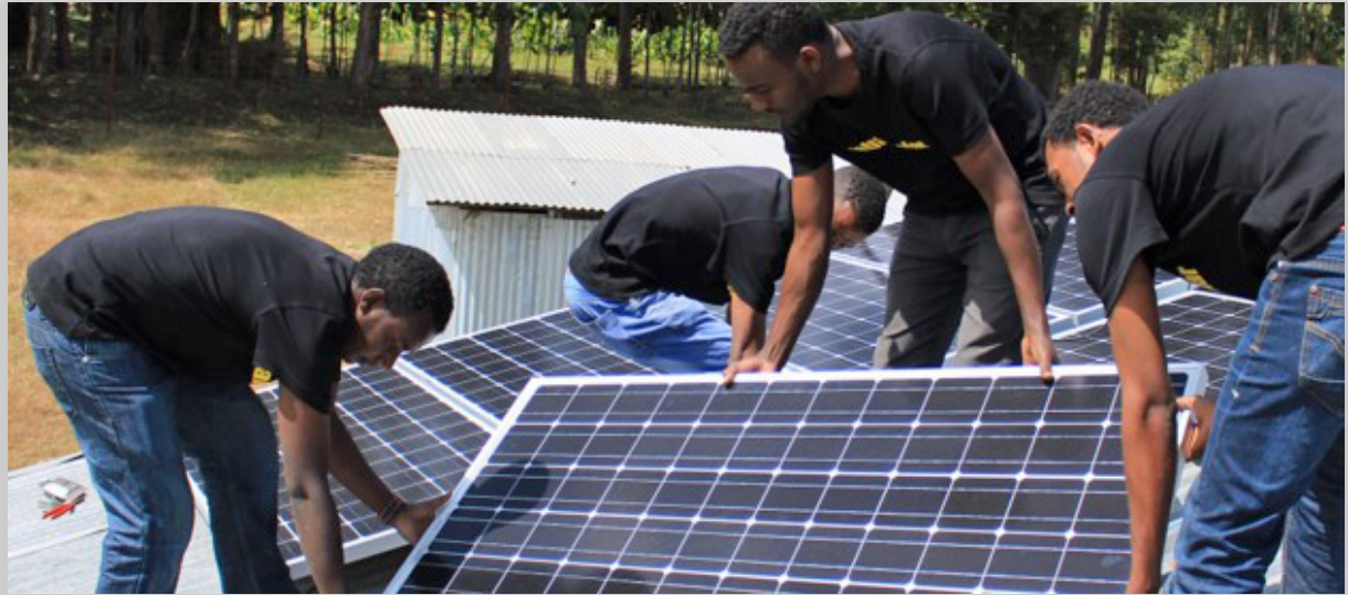
Figure 3: Dans une région qui compte 700 000 habitantes et habitants, 27 dispensaires ont été électrifiés à l'aide d'installations photovoltaïques à l'initiative de Sahay Solar (voir chap. 4).
