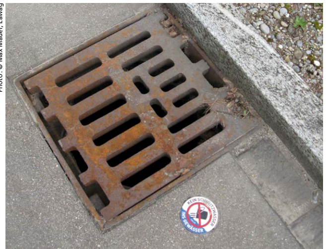
La plaque signalétique placée à côté de la bouche d'égout indique que cette canalisation conduit à un ruisseau, à un lac ou à des eaux souterraines.
