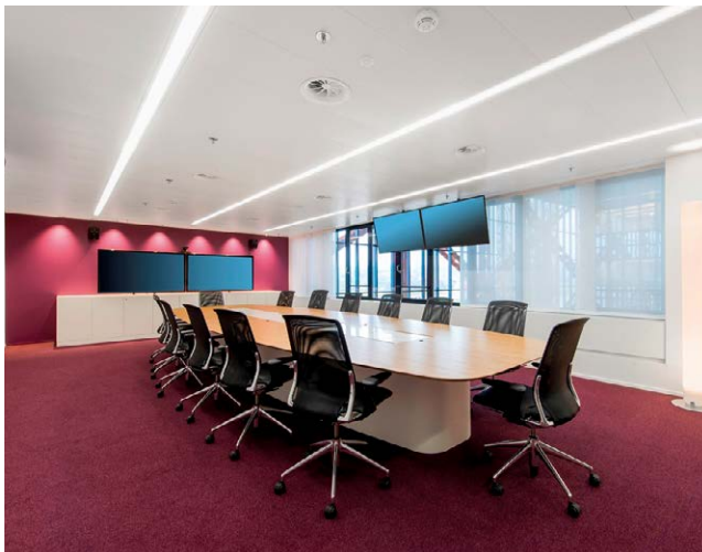
Salle de réunion avec installation de vidéoconférence professionnelle chez MétéoSuisse à Kloten
