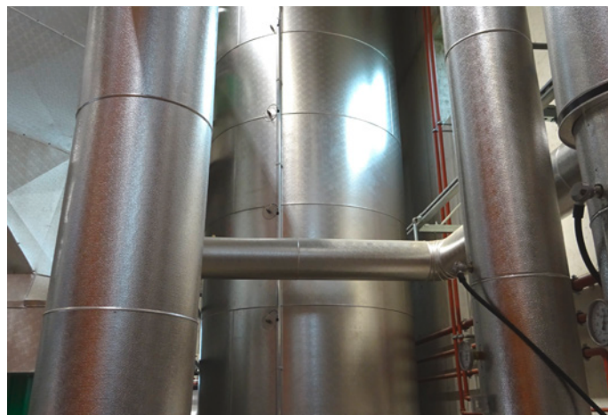
Dank einem Speichervolumen von 25 000 Liter kann die Fernheizzentrale in Düdingen eine grosse Wärmemenge speichern. Quelle: Marcel Gutschner
