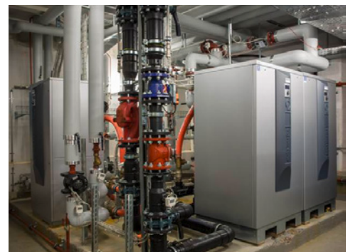
Dezentrale Wärmeerzeugung: Gebäude mit eigener Wärmepumpe. Quelle: EKZ
