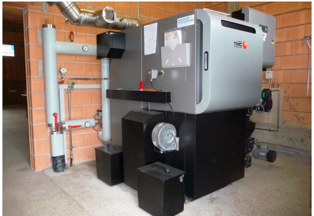
Heizkessel, der Wärme für mehrere Gebäude im Weiler Litzistorf (Bösingen) produziert. Quelle: Marcel Gutschner
