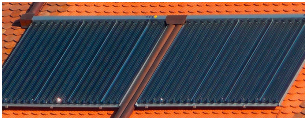
Vakuumröhrenkollektoren in Garmiswil (Düdingen). Quelle: Marcel Gutschner
