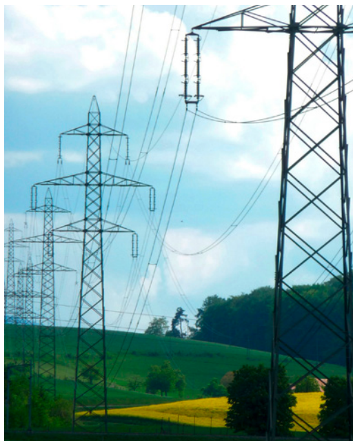
Der Kanton Freiburg verfügt über ein mehrere Tausend Kilometer langes Verteilnetz, um die Endverbraucher mit Strom zu versorgen. Im Bild: Strommasten in Galmis (Düdingen). Quelle: Marcel Gutschner
