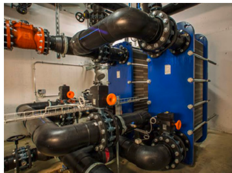
Wärmetauscher und kaltes Netz. Quelle: EKZ
