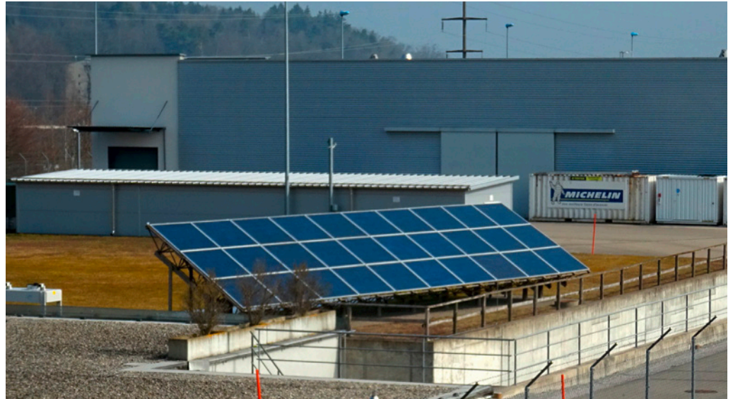
Photovoltaikanlage für die Elektrolyse und Produktion von Wasserstoff in Givisiez. Quelle: Marcel Gutschner
