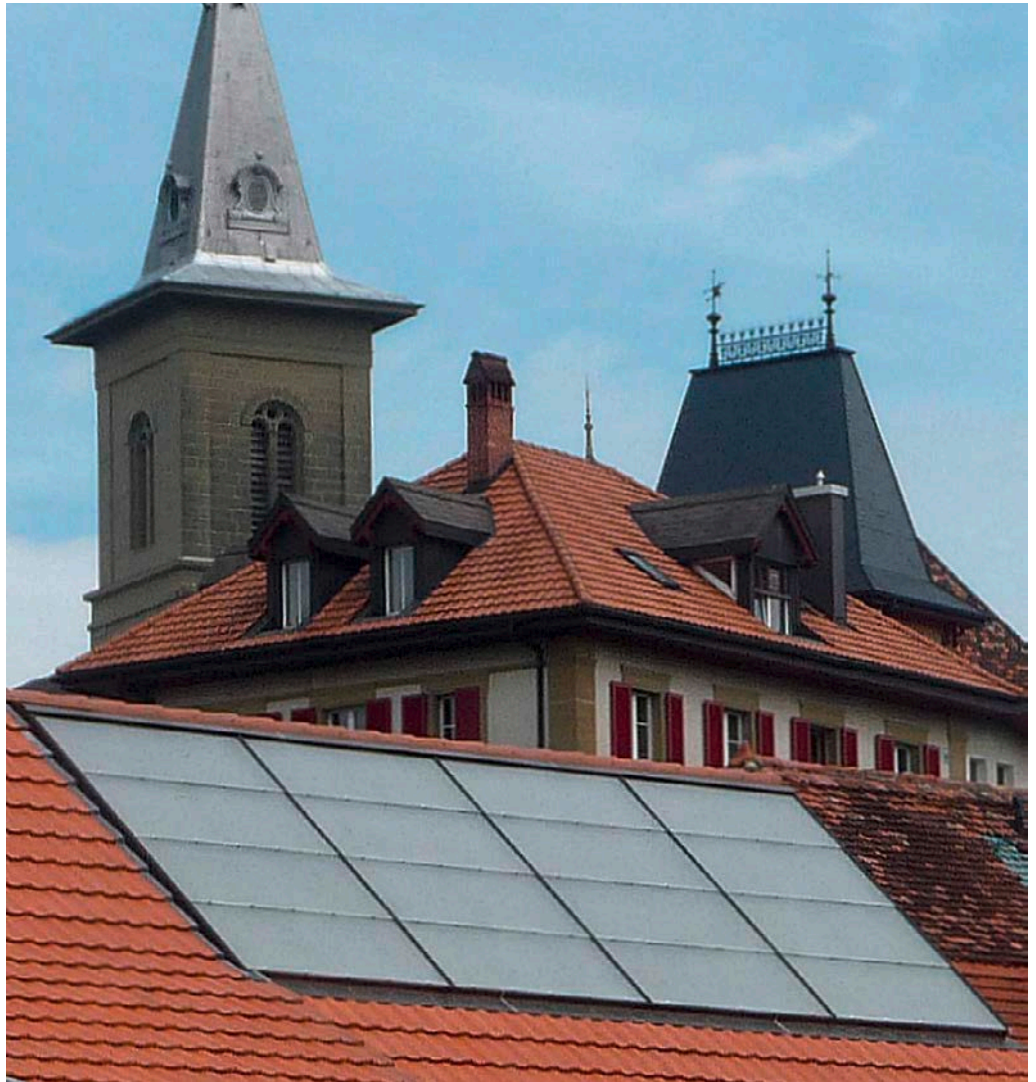
Verglaste Flachkollektoren in Belfaux. Quelle: Marcel Gutschner
