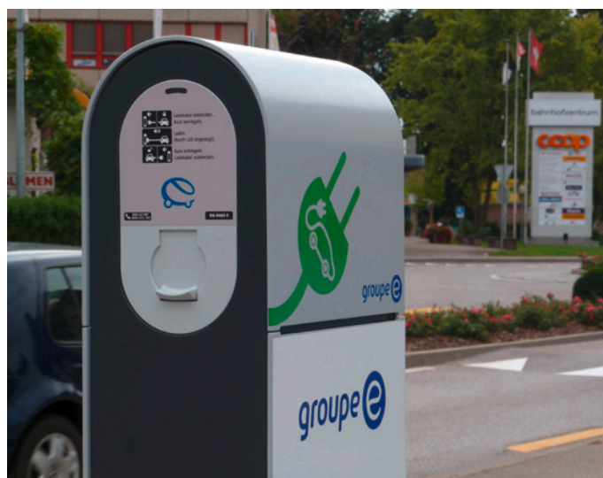
Ladestation. Quelle: Marcel Gutschner
