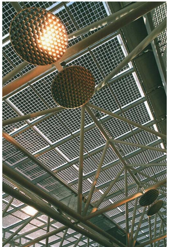
Abbildung 36: Einkaufszentrum in Zürich. Das Glasdach der Vorhalle mit Isolierglas-integrierter Solaranlage (30 kW) liefert Strom für das Elektrizitätswerk der Stadt Zürich (ewz). Quelle: energiebüro Zürich
