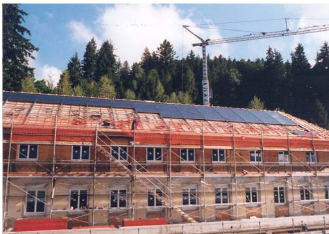
Abbildungen 80 und 81: Solarstrom in Zug. Installation der Solaranlage auf dem Dach der Höhenklinik Adelheid, Unterägeri (ZG). Die Wasserwerke Zug (WWZ) betreiben diese Anlage und verkaufen den Solarstrom direkt an ihre
