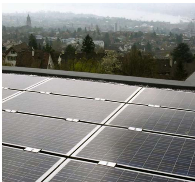
Abbildung 96: Photovoltaikanlage auf dem Flachdach eines Einfamilienhauses in Zürich. Die Anlage weist eine Leistung von 5,76 kW aus. Quelle : BE Netz, Luzern
