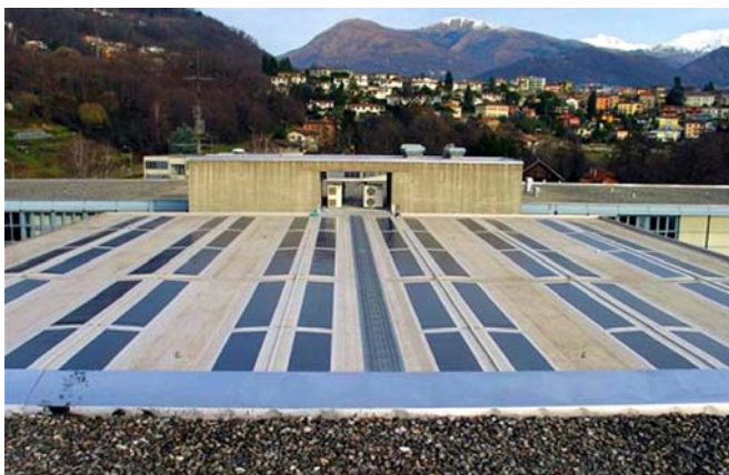
Abbildungen 54 und 55: Innovative Integrationslösungen aus Schweizer Produktion auf den Dächern des Centro Professionale in Trevano (TI) und des Flumroc-Fabrikgebäudes in Flums (SG). Beim Sarnasol Photovoltaik System (Beispiel in Trevano) sind die flexiblen Photovoltaik-Lamine mit der
