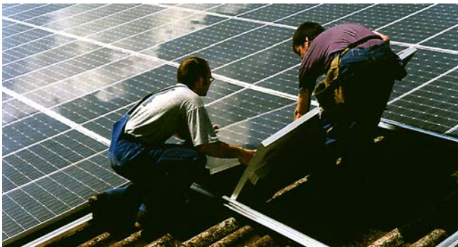
Abbildungen 74 und 75: Photovoltaikanlagen in Hünenberg (ZG). Ein Scheunendach und ein Sportzentrum beherbergen je eine Anlage.
