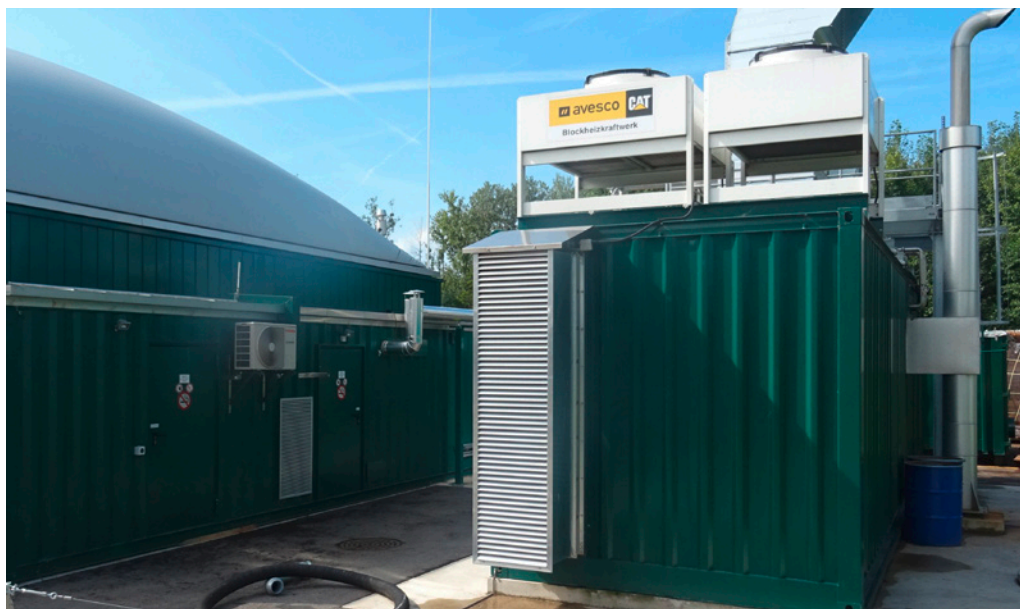
WKK-Anlage mit einer elektrischen Leistung von 150 kW am Standort der Biogasanlage der Firma Kompostieranlage Seeland AG auf dem Gebiet der Gemeinde Galmiz. Die Anlage verwertet das aus etwa 4500 Tonnen Grünabfällen gewonnene Methan und wandelt es in etwa 760 MWh Strom und 730 MWh Wärme um. Quelle: Marcel Gutschner
