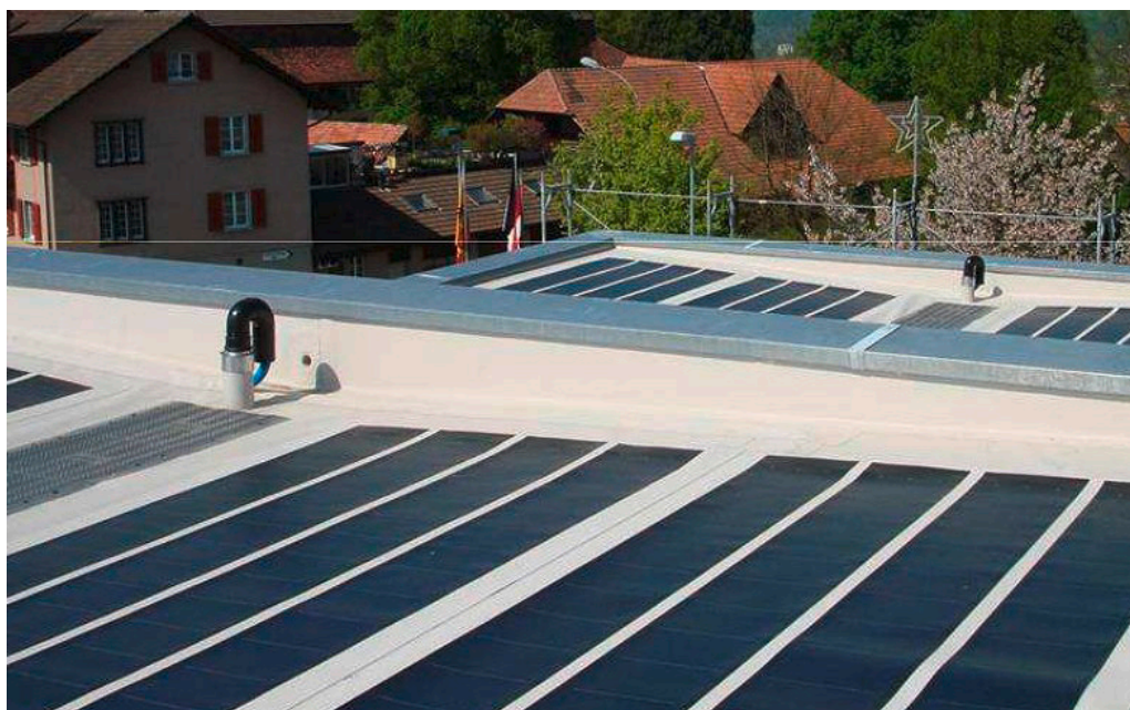
Dünnschichtzellen auf einem Kirchendach in Bödingen. Quelle: Sika Sarnafil
