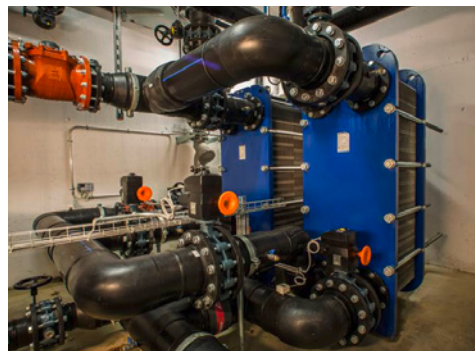
Wärmetauscher und kaltes Netz. Quelle: EKZ
