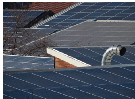
Praktisch alle geeigneten Dachflächen dieser Schreinerei in Le Mouret wurden mit Photovoltaik-Modulen ausgestattet. Quelle: Marcel Gutschner
