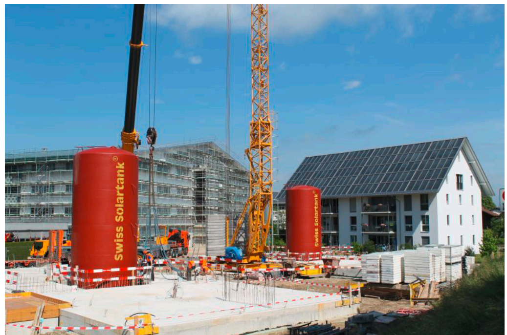
Neubauten, die zu 100 % mit Sonnenenergie geheizt werden. Die Warmwasserspeicher werden zu Beginn der Arbeiten aufgestellt. Quelle: Jenni Energietechnik
