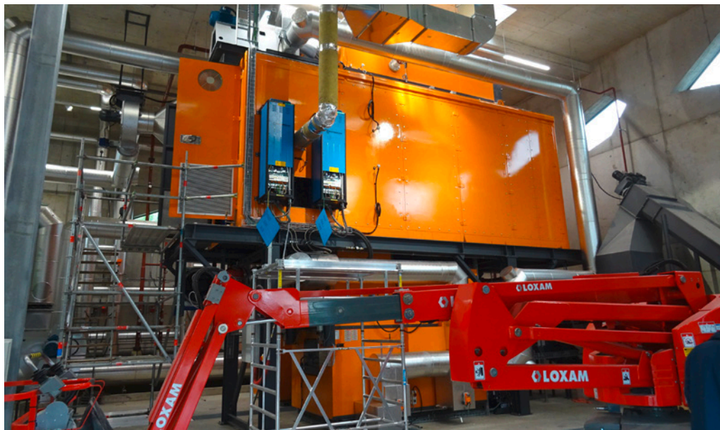
Die WKK-Anlage in Düdingen wurde im Sommer 2016 in Betrieb genommen. Quelle: Marcel Gutschner
